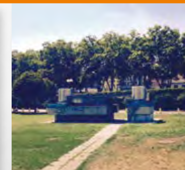
Entrauchungsventilatoren auf der Freifläche über der Tiefgarage des AKH Wien.
