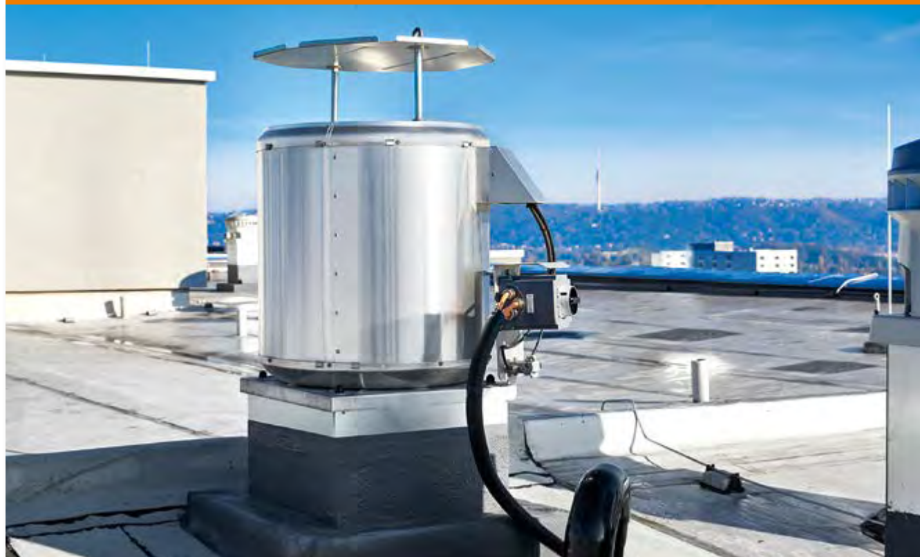
Drei Bus-Leitungen genügen: eine Spannungsversorgung für den Schaltschrank, eine Spannungsversorgung für den Entrauchungsventilator und eine Kommunikationsleitung zum TROX X-FANS Entrauchungsventilator BVD 315 auf dem Dach der Wohnhochhäuser in Dresden-Prohlis.
