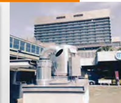
Entrauchungsventilator, AKH Wien.
